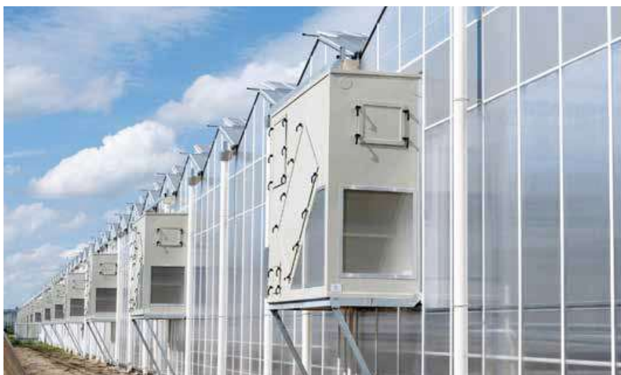
Aan de gevel hangen lucht-lucht warmtewisselaars, asymmetrisch ontworpen omdat de warmte in de vochtige kaslucht groter is dan wat de droge buitenlucht kan opnemen.
