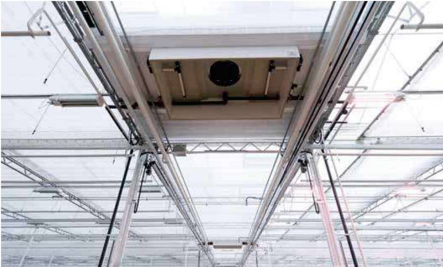
De kasten boven het middenpad winnen warmte terug via lucht-water warmtewisselaars aangesloten op een warmtepomp.
