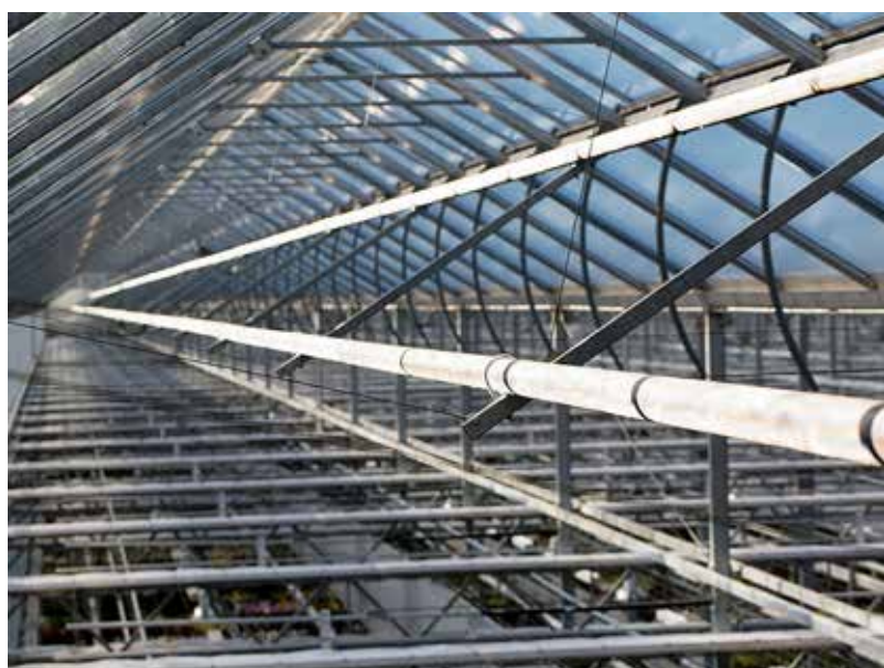
De Fresnel-lenzen van de Daglichtkas concentreren direct zonlicht op beweegbare buizen gevuld met water.
