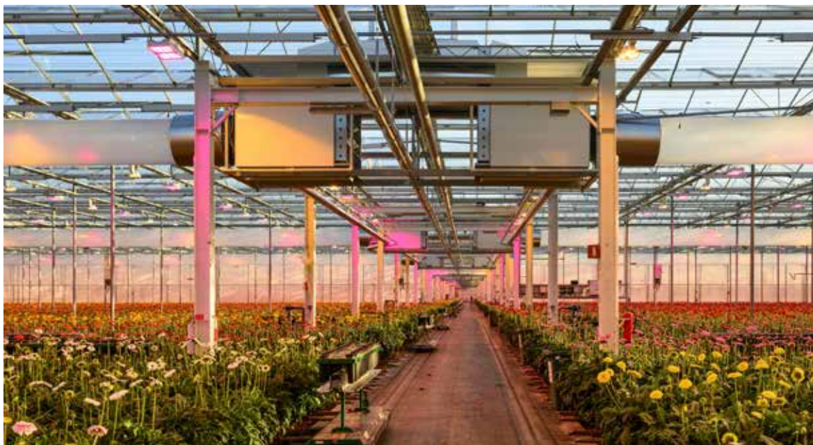
De kas van Holstein Flowers is uitgerust met twaalf dubbele LBK's die vanuit het kasdek de buitenlucht aanzuigen en via slurven in de kas verdelen.
